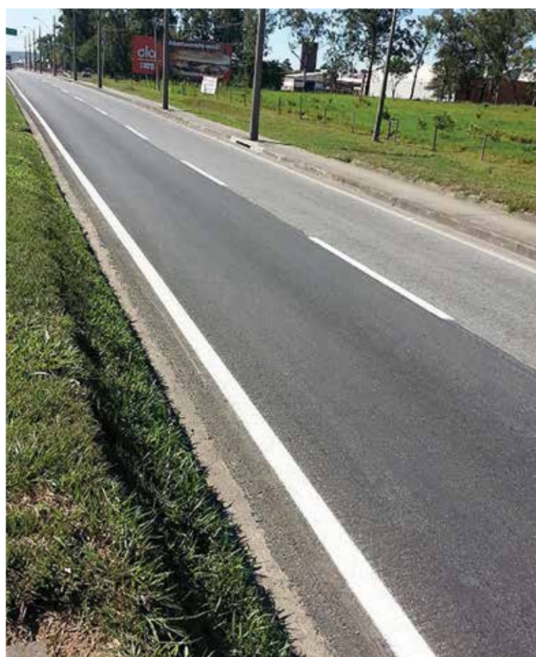
Figura 8: Detalhe do trecho em 13/07/2015 – 11h29 (21 dias após a aplicação).
