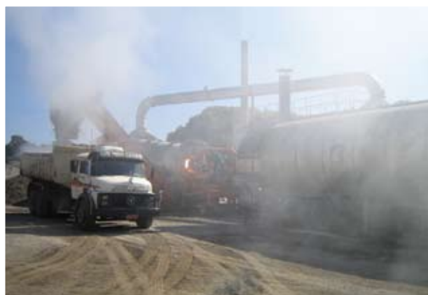
Usina de Asfalto.
