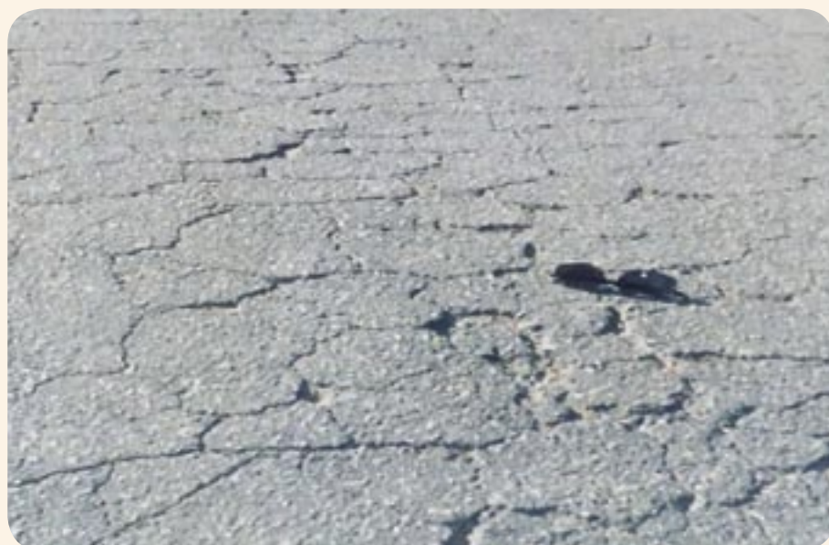
Figura 2 – Trincas tipo “couro de jacaré”
